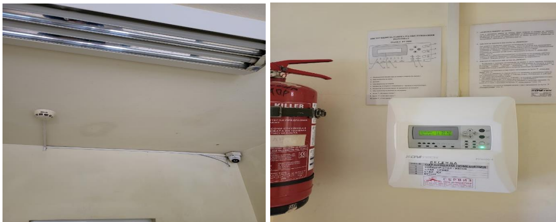
Изградена пожароизвестителна система
